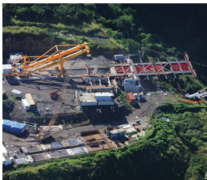
Photo 4b Le 2 e tronçon est posé sur le tablier rive droite Second section placed on right bank deck
