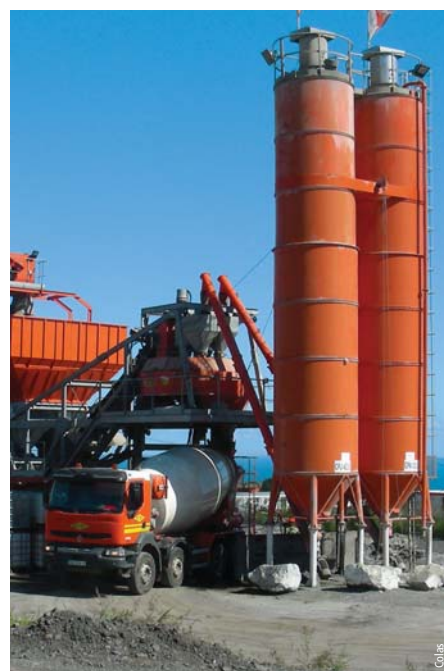
Photo 8 Centrale à béton de l'Eperon dédiée au chantier Dedicated concrete mixing plant for Eperon works
