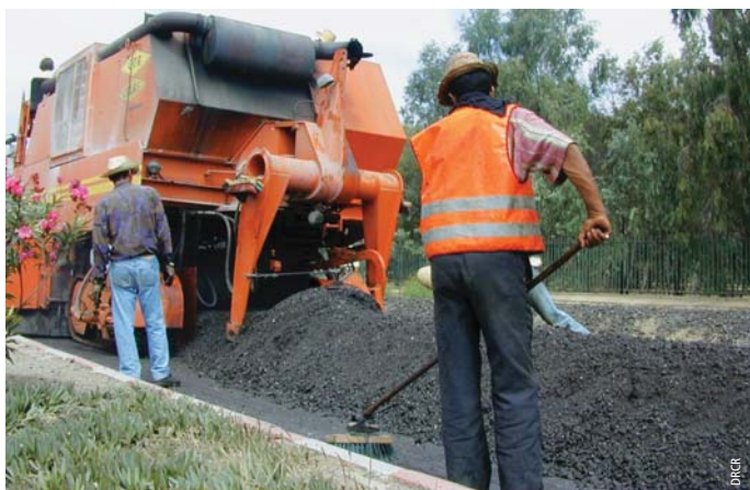
Photo 6 Retraitement en place de chaussées à froid In-place cold retreatment of pavements
