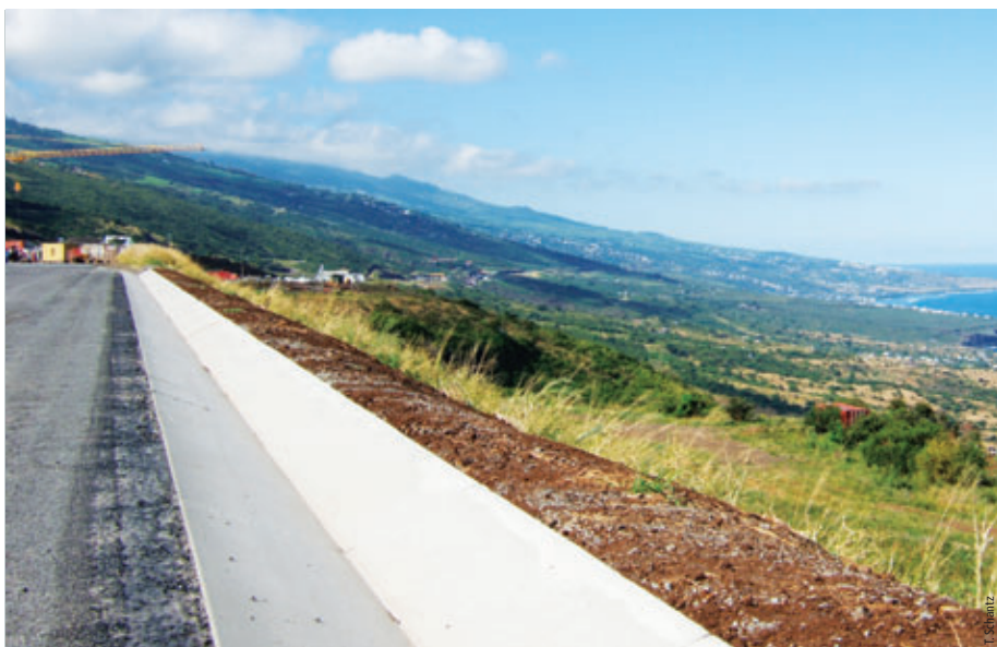
Photo 1 « Route balcon » surplombant la côte ouest depuis le « barrage » "Balcony road" overlooking the west coast from the "dam"
