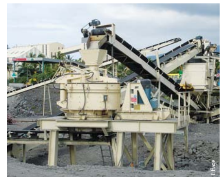
Photo 1 Installations Ouest Concassage à Saint-Paul West crushing installations in Saint-Paul
