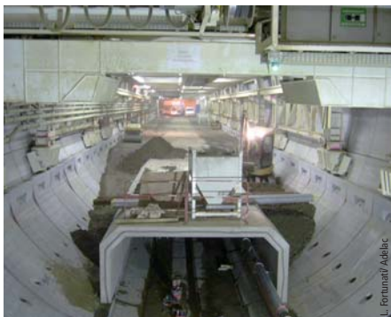
Photo 1 Galerie technique en partie basse du tunnel Pipe gallery in the lower section of the tunnel
