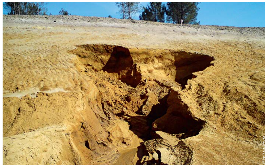
Photo 3 Erosion régressive dans les talus sableux du déblai D41 Regressive erosion in sandy slopes of highway D41 cutting
