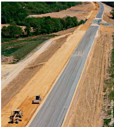
Photo 1 Traitement à la chaux de la grave alluvionnaire Lime treatment of alluvial aggregate
