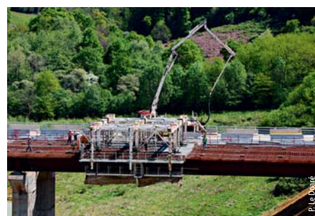
Bétonnage du hourdis du Viaduc du Gabas Gabas viaduct – Deck slab pouring
