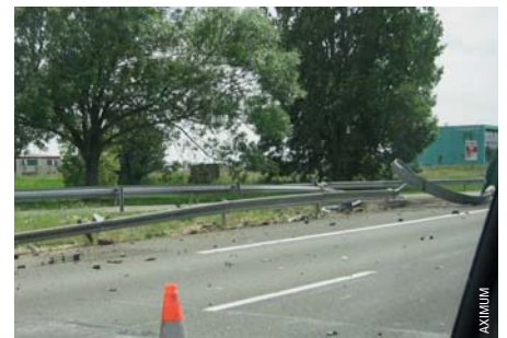
Photo 3 Accident sur un musoir avec rupture de la glissière Accident on bullnose with broken guardrail
