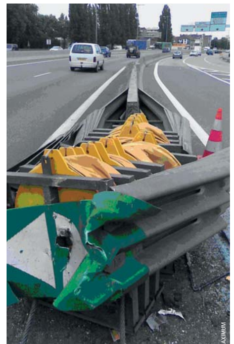
Photo 4 Accident sur un atténuateur de choc qui a parfaitement rempli son rôle d'amortisseur de choc Accident on impact attenuator that fully performed its crash damping function
