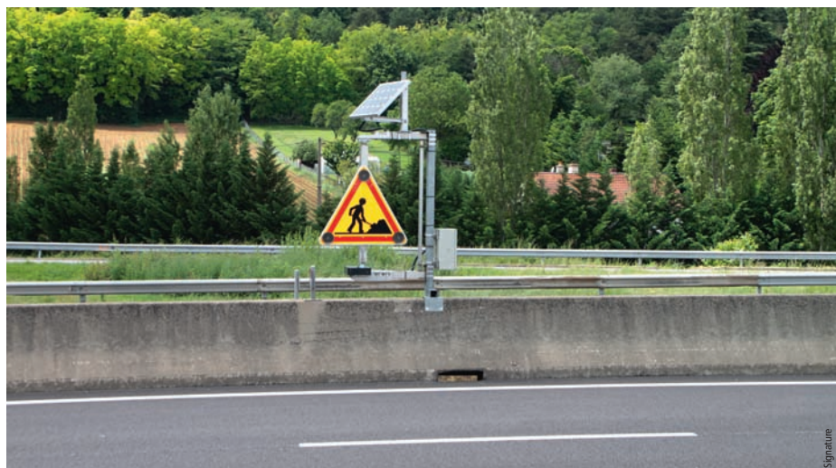
Pré-séquençage automatique Signature, alimentation photovoltaïque, réalisée pour APRR Signature automatic pre-sequencing, photovoltaic power supply, completed by APRR
