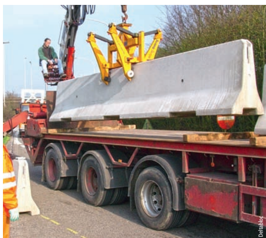
Installation du DB 80
