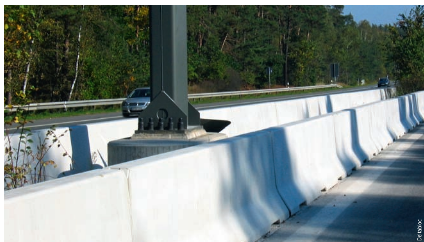
DB 80 en sécurisation des obstacles entre TPC et accotement
