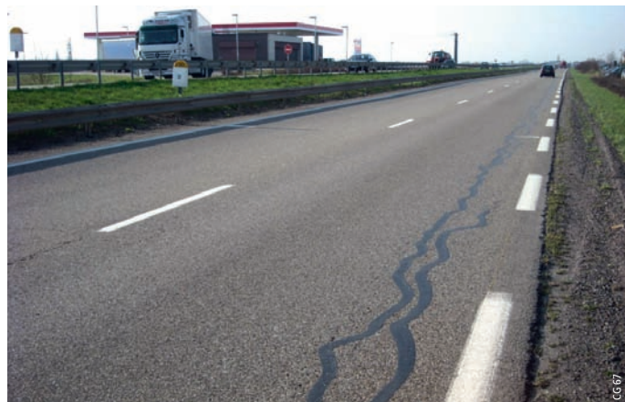
Photo 1 Etat de surface de la RD 1083 (67) avant travaux d'entretien Surface condition of highway RD 1083 (67) before maintenance works
